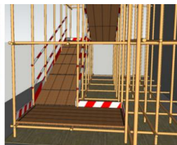
图40、钢管扣件式马道内部构造一
