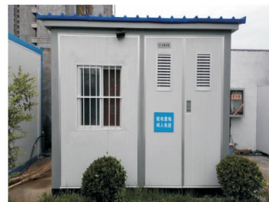
集成式总配电室
