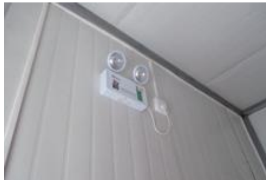
应急照明实景图
